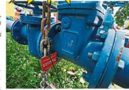
要水已上鎖的水管，周二凌晨進入宵宵，不過最後還是被水供公司鎖掉。
