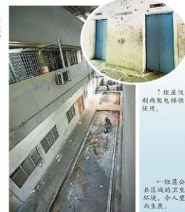
↑組屋僅剩兩部電梯使用。 ←組屋公共區域的衛生環境，令人望而生畏。
